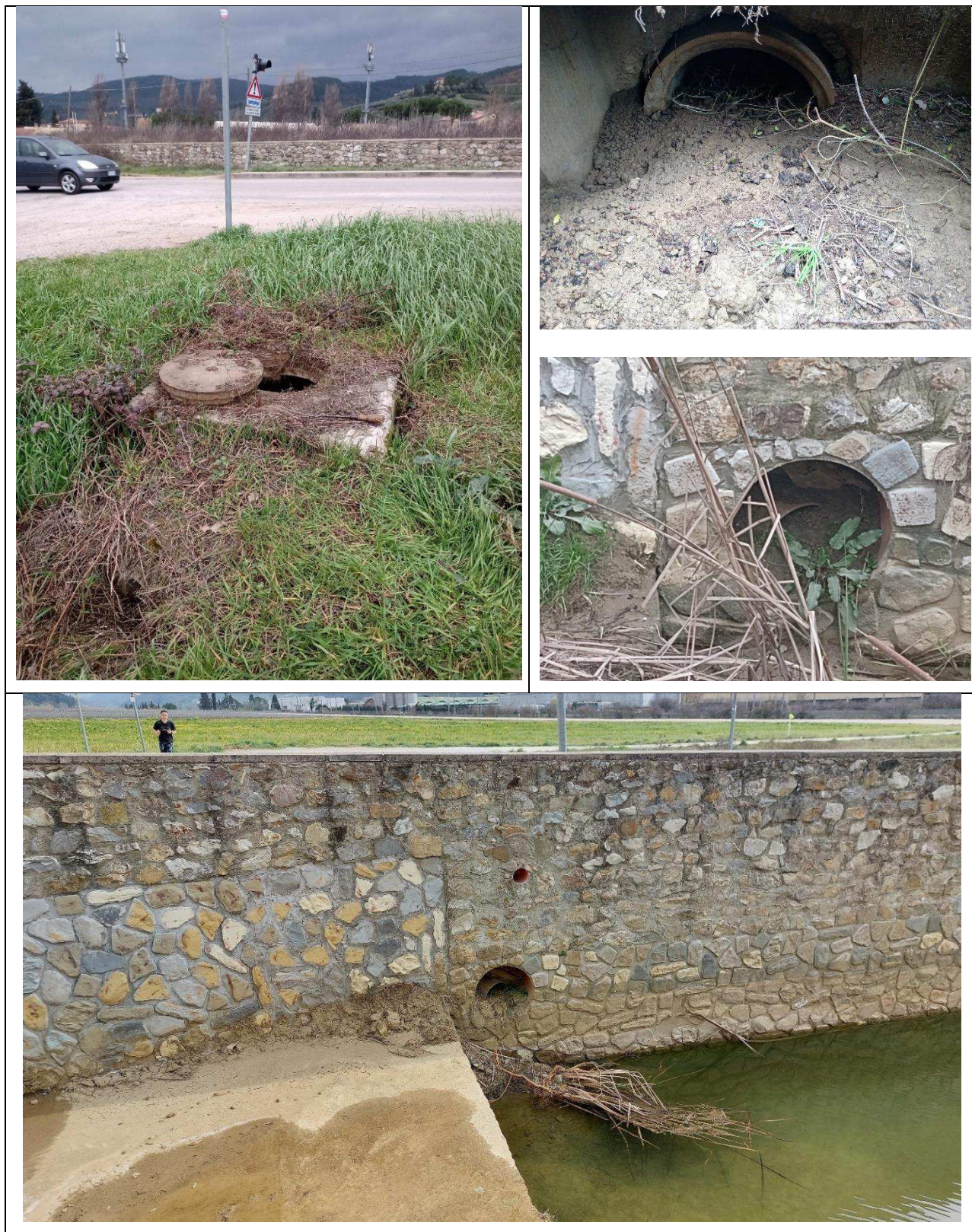
Figura 3 - Tubazione di scarico esistente in cls DN400 dal lotto alla vasca di calma del Borro Ragnai
