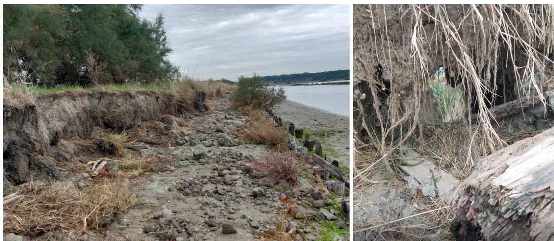
Punti di massimo cedimento arginale in cui l'erosione sta avanzando (sx); e cedimenti a piè di argine in cui si sono creati dei varchi (dx).
