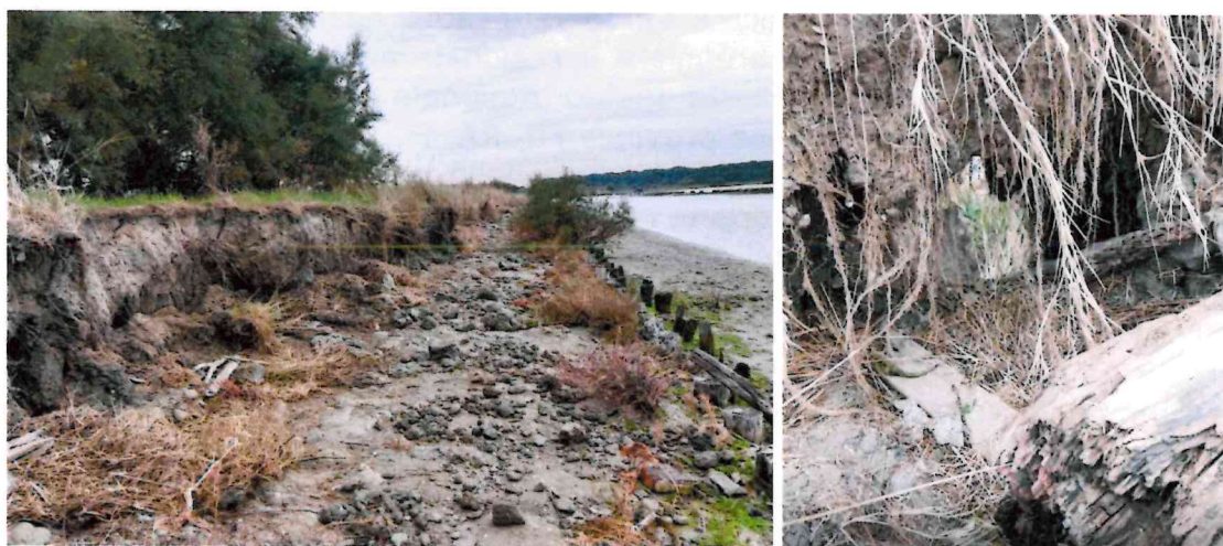
Punti di massimo cedimento arginale in cui l'erosione sta avanzando (sx); e cedimenti a piè di argine in cui si sono creati dei varchi (dx).
