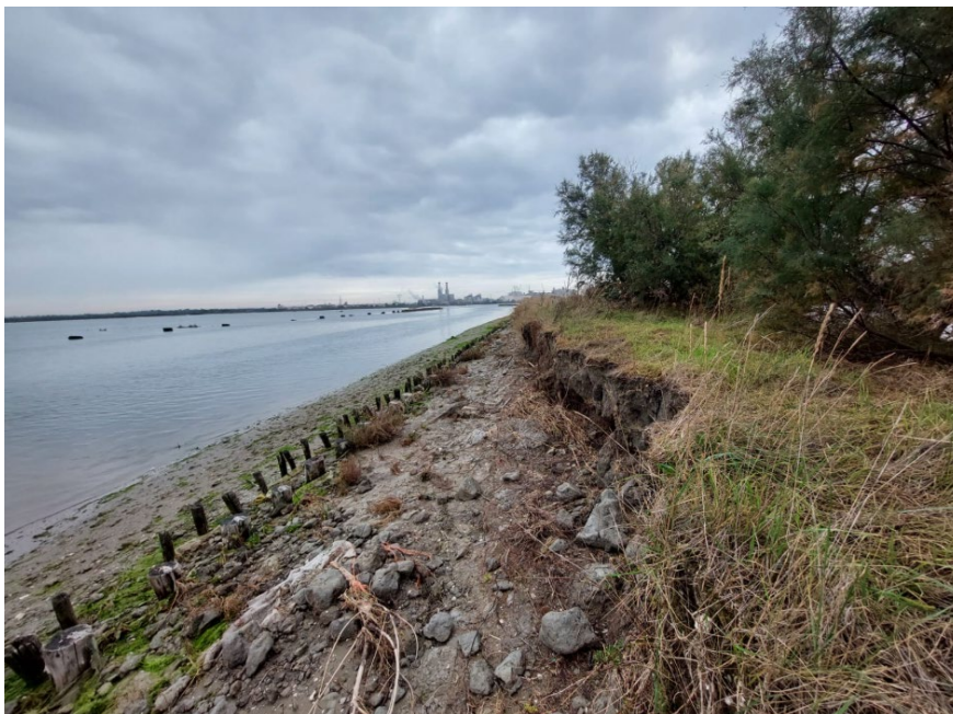
Punti di massimo cedimento arginale in cui l'erosione sta avanzando
