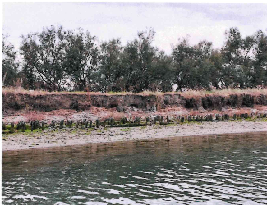
Punti di massimo cedimento arginale in cui l'erosione sta avanzando
