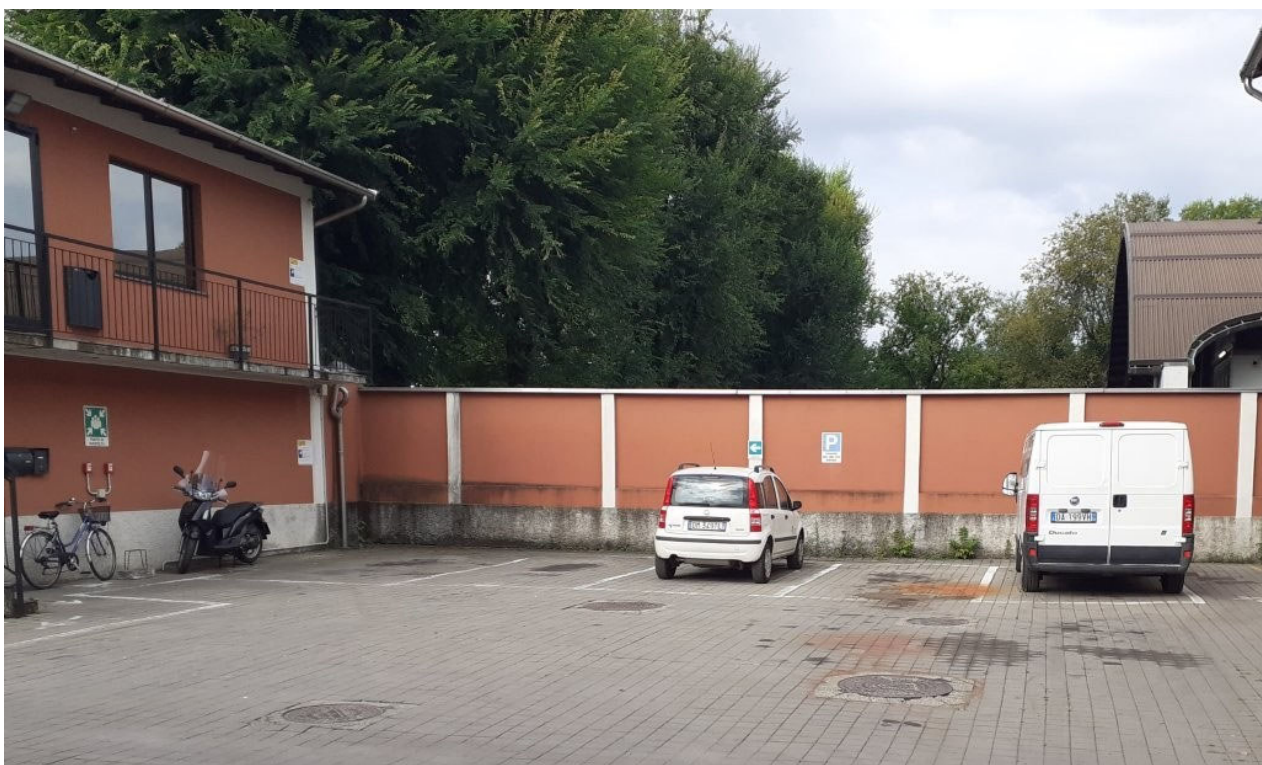
Foto 1: Vista edificio e recinzione esistente nella zona in cui verrà posizionato il nuovo blocco spogliatoio
